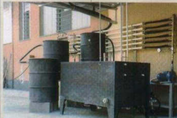
Impianto di ultrafiltrazione e trattamento acque.
