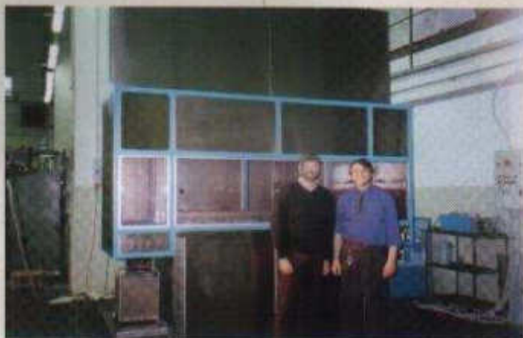
Impianto di lavaggio a ultrasuoni.
